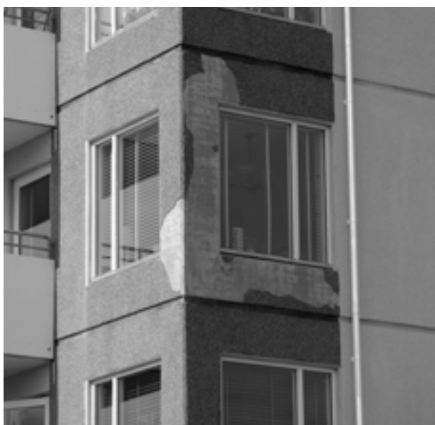
Þegar nýjar byggingar eru steinaðar þarf að gæta vel að undirlagi, steiningarlími, vinnubrögðum og frágangi; ella getur farið eins og sést á þessari mynd af nokkurra ára gömlu fjölbýlishúsi í Reykjavík.
