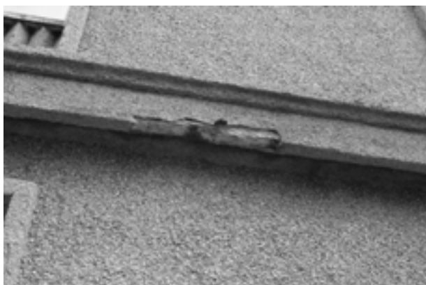
Frostsprungin steining og ryðskemmdir.
