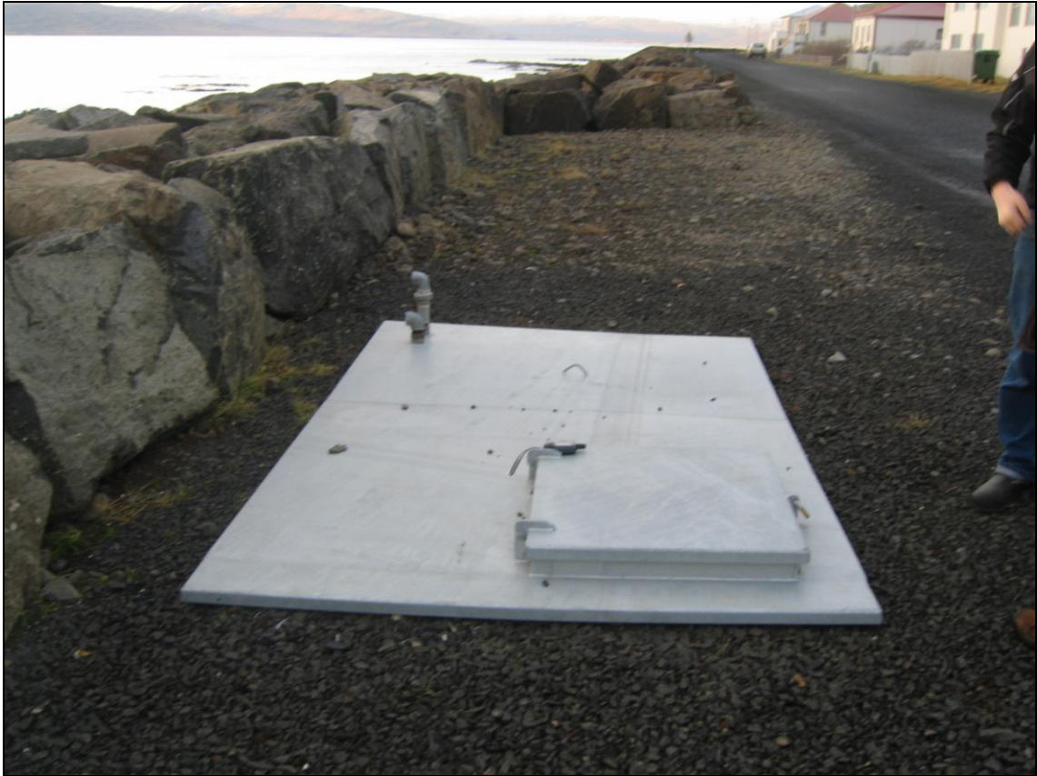
Mynd 17. Borhola DN-16. Boruð 27. júlí til 8. ágúst 1998. Dýpi er 276 m. Í holunni er 10" yfirborðsfóðring, líklega niður í þrjá metra, en 8" fóðring er steipt niður á 54,4 m dýpi. Síðan var steipt í holuna niður í 153 m dýpi. Á holutoppi var 8" flans sem þrengdur var í 5".
