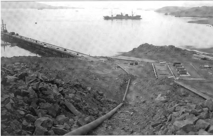
Átta og tólf þumlunga leiðslur fluttu olíu milli geymanna og bryggjunnar. Auk þess lá sex þumlunga vatnsleiðsla og gufu-leiðsla fram bryggjuna. Myndin sýnir bráðabirgðaleiðslu fram á bryggjuna í júní 1942. (NARC 80-G-319931)
