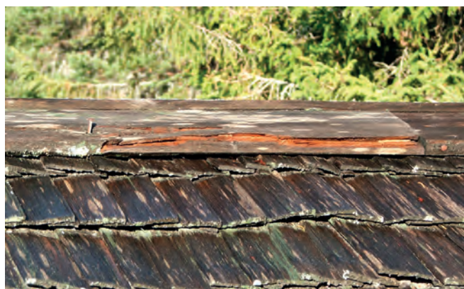
Råteskadet tak på middelalderloft i Fyresdal, Telemark.
