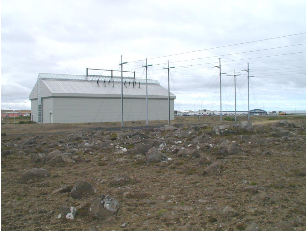
MYND 4.1 Suðurnesjalína og Fitjalína tengjast aðveitustöð á Fitjum.
