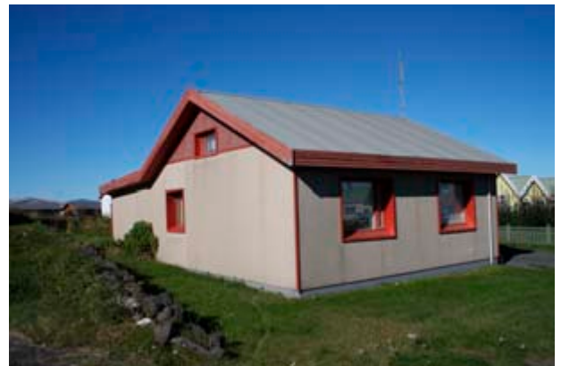
Garðbær byggt árið 1939 úr holsteini, síðar var steipt utan á vegg og þeir loks klæddir steniþlötum.
