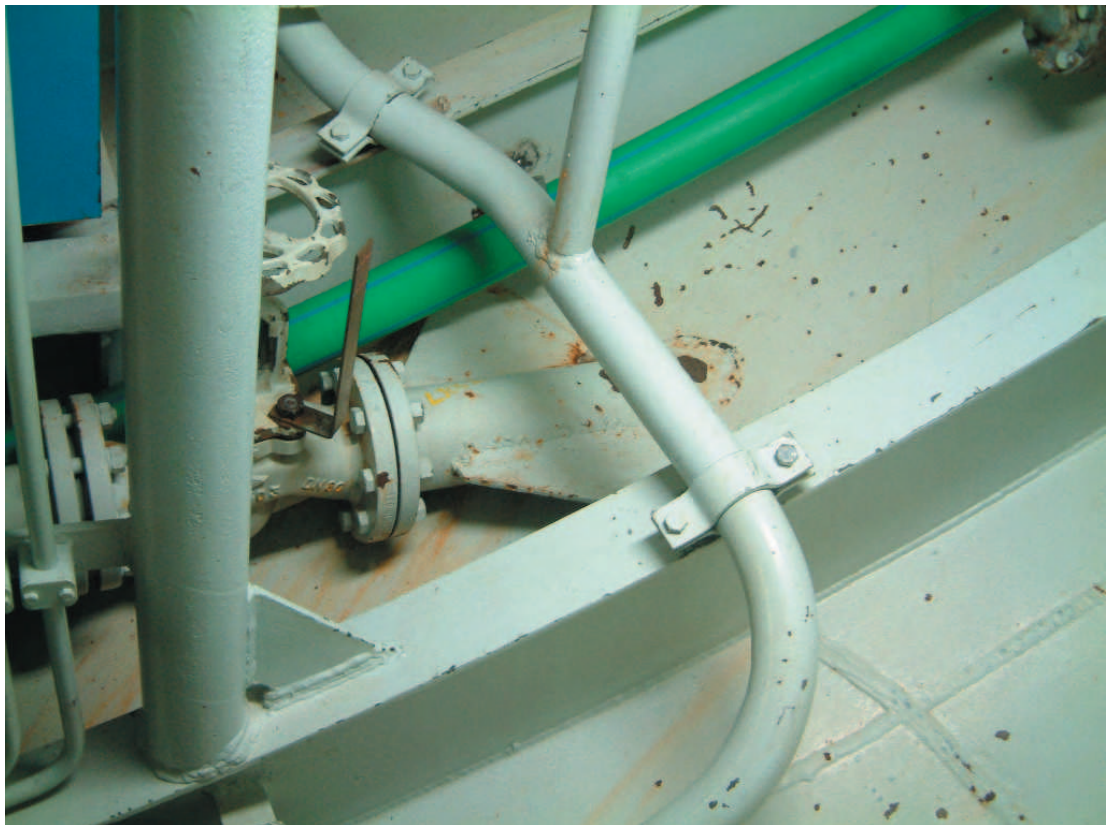
D7: Tenging botnloka við byrðing um hættulega langt rör í stað plötuflansa.
