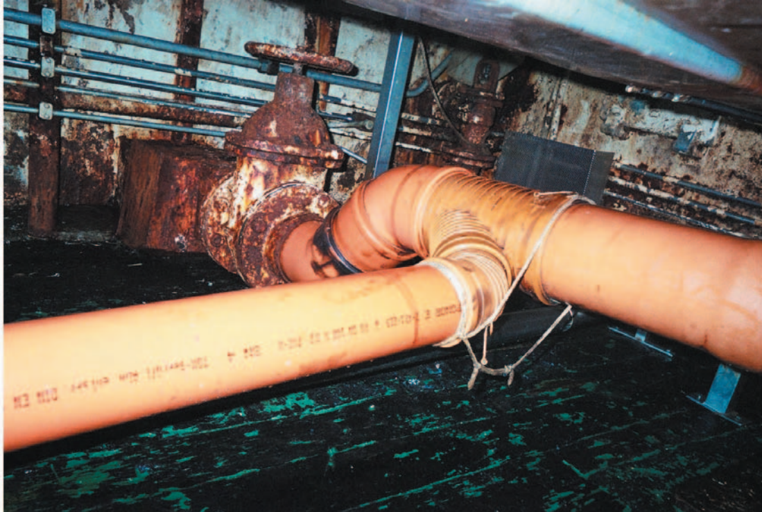
A3: Frárennslisrör á vinnsluþilfari; plaströr losaralega frágengin; óvirkur loki.
