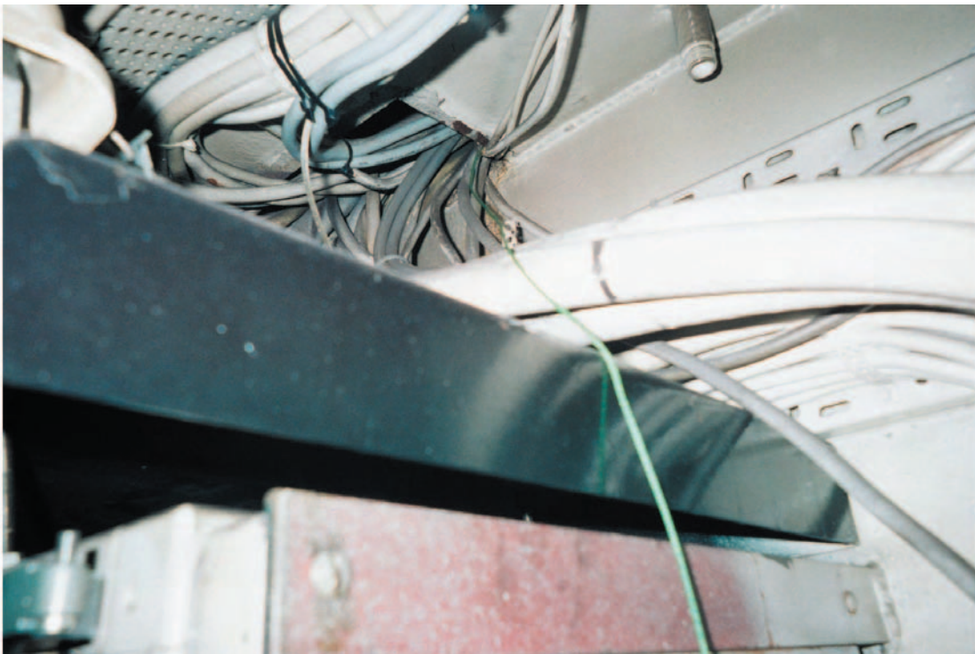
A2: Gegnumtök kapla upp um þilfar til stýrishúss, óþétt með öllu.
