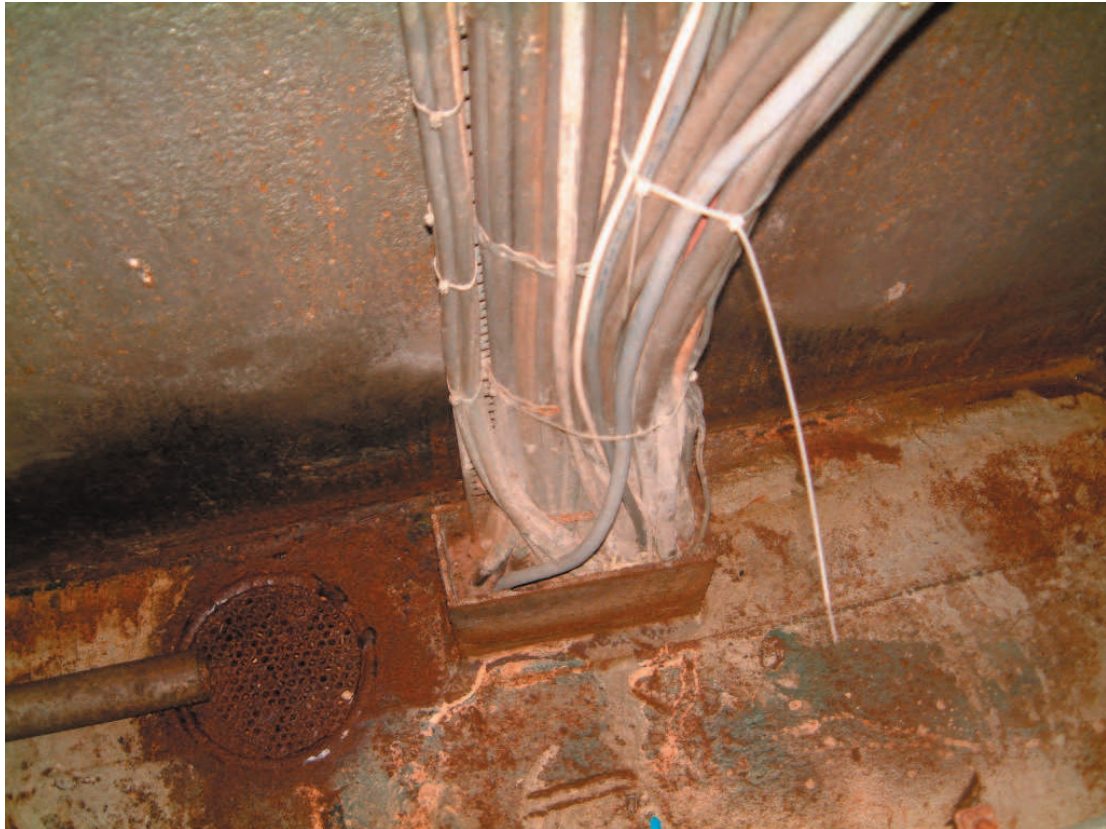
B1: Gegnumtak fyrir kaplabúnt í aðalþilfari illa þétt og óvarið fyrir hnjaski.
