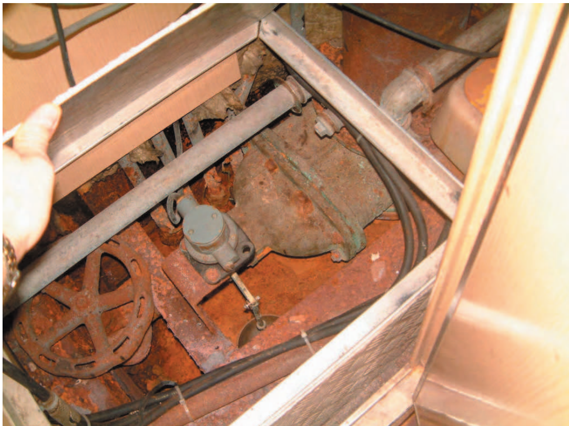
E2: Botnloki og flotrofi undir íbúðarymi framskips, umhirðu ábótavant.
