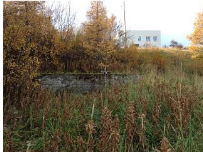
IMG_0340 Steyptur grunnur vestur af Skarðshlíð 23-27, gæti tengst þurrabúðarbýlinu Garðshorni (1786-11). Horft vestur, íbúðarhúsið Melgerði í baksýn.
