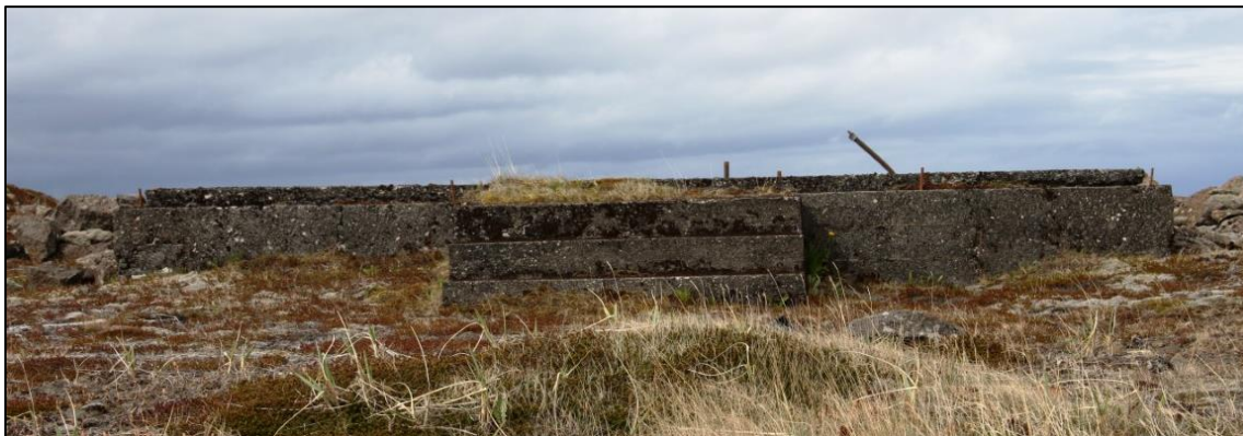
Mynd 29 Hvalsnes hverfið. Húsgrunnur og tröppur [752] í heiðinni fyrir ofan Hvalsnes.
