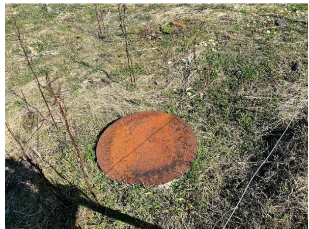
Mynd 26. Brunnur með járnloki.
