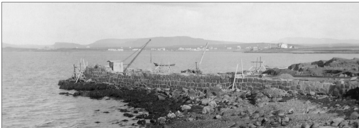
Mynd 7. Unnið við uppbyggingu á bólverki við Klöpp, þar sem Olústöð BP. við Skúlagötu reis. Til hægri á myndinni eru klappirnar sem Klöpp var kennd við og Klapparvör fremst á myndinni. 22
