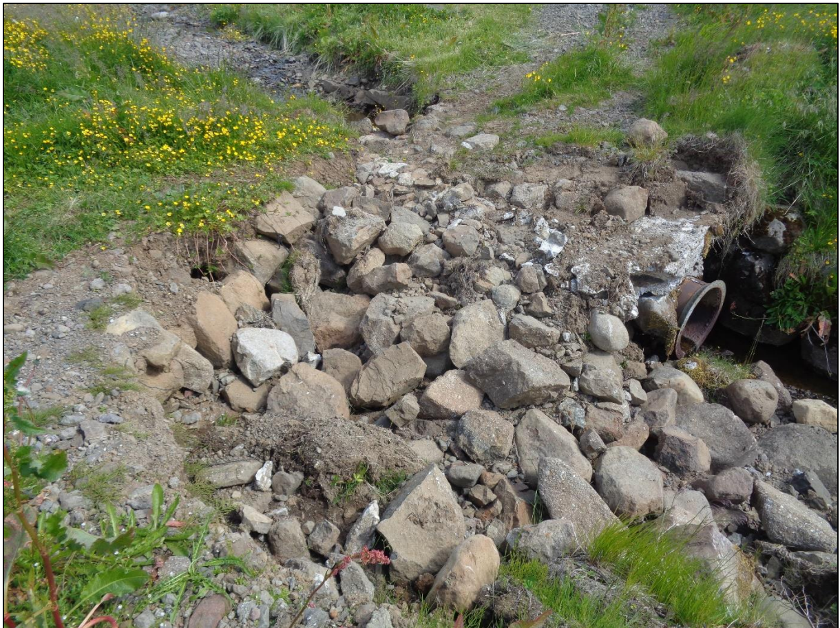
Mynd 29. Hálfhrunin brú [170] yfir bæjarlækinn sem var hluti af gamla þjóðveginum [190].
