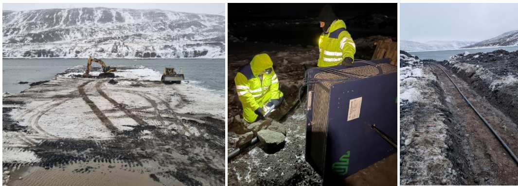
Mynd 21 – Mynd til vinstri, rás gerð í fyrsta lag fyllingar. Miðju mynd, mælir á kefli og unnið við að koma mæli í slönguna (rörið). Mynd til hægri, búið að koma mælinum í slöngu og leggja í rásina.
