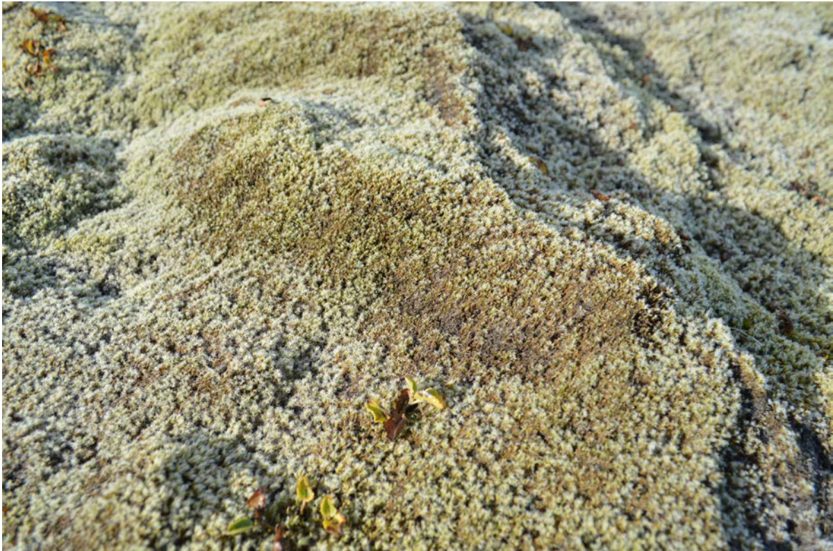
17. Ljósmynd. Nærmynd af B-skemmdum í reit S-4000 við Hellisheiðarvirkjun. Í reitnum voru B-skemmdir sérlega algengar. Ljós. Járngerður Grétarsdóttir, 7.september 2022.
