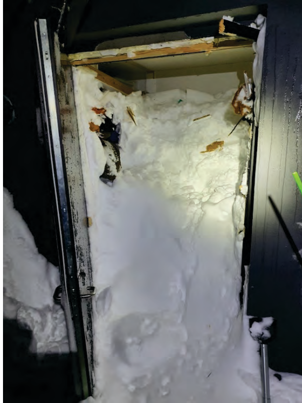
Mynd 43. Mynd tekin fyrir utan húsið og horft inn um aðaldyrnar og í átt að fjallinu. Anddyrið er fullt af snjó. Herbergi unglingsstúlku er fyrir innan.
