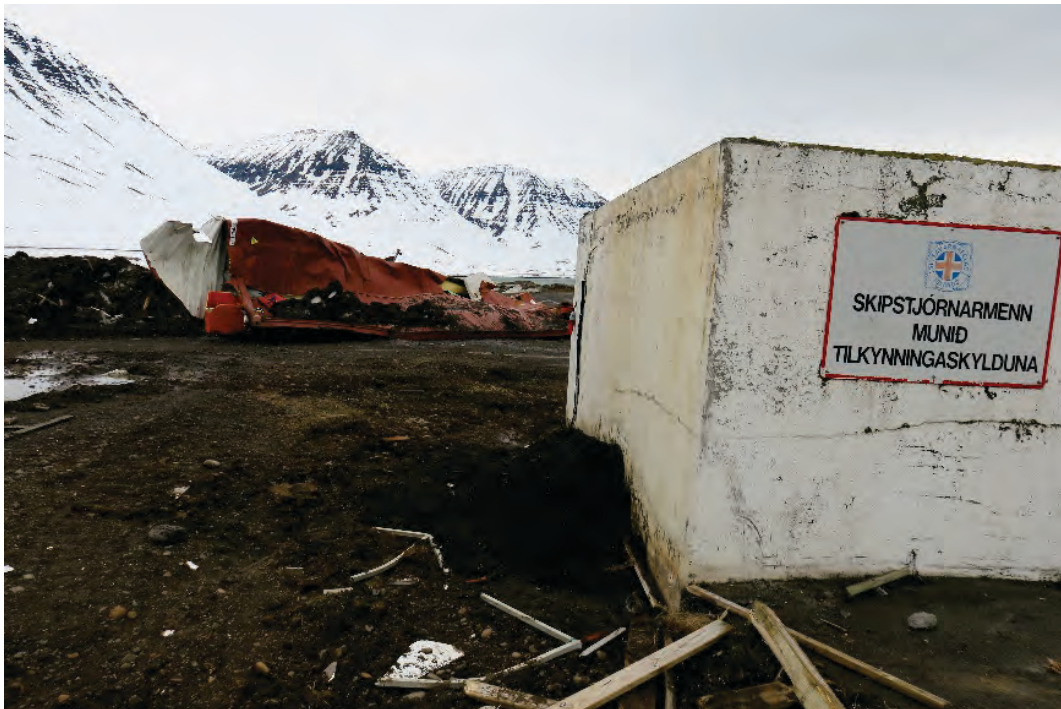
Mynd 29. Steyptur skúr við smábátahöfn sem skekkist um 6°. Búið er að fjarlægja stálmastrið sem var ofaná. Gámarnir fyrir aftan voru uppvið skúrinn þegar flóðið féll og búið er að færa brakið til.
