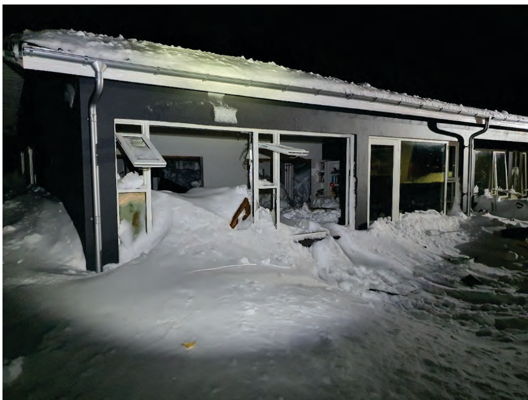
Mynd 40. Ólafstún 14, neðri hlið hússins. Um 1 m af snjóflóðsnjó er í stofunni og eldhúsi. Tvær af stóru rúðunum eru brotnar og opnanlegu fögin standa nánast lárétt út.
