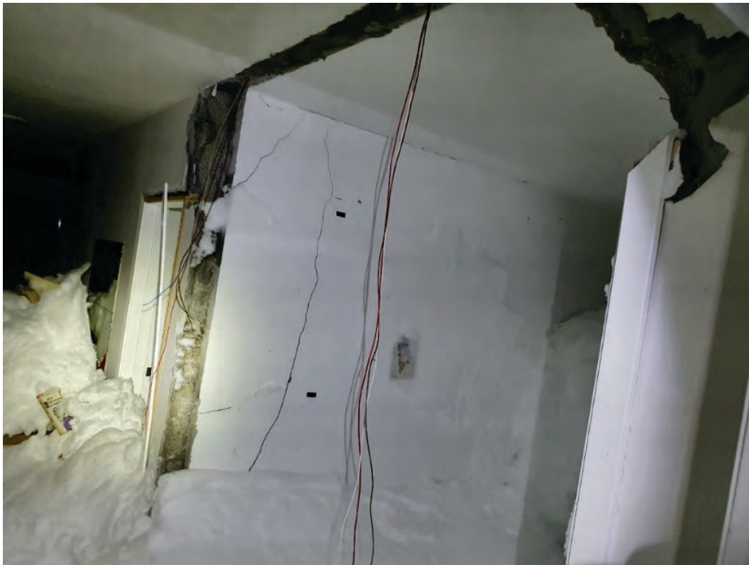
Mynd 44. Horft af ganginum og inn í herbergi unglingsstúlkunnar sem grófst. Veggurinn sem aðgreindi herbergið og ganginn brotnaði.
