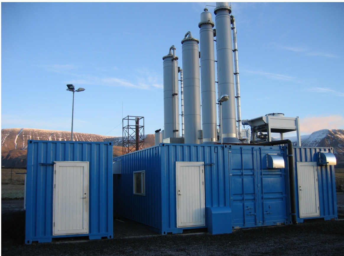
Hreinsistöð fyrir hauggas í Álfsnesi (Ljósmynd: Mannvit)
