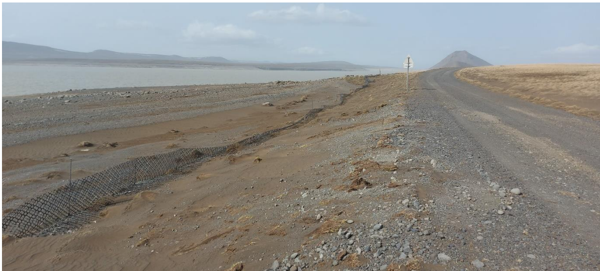
Mynd 12. Fokgirðing norðarlega á Lindabungu sem þarf að yfirfara og strekkja í sumar en jafnframt þyrfti að bæta við sandgildru á þetta svæði.
