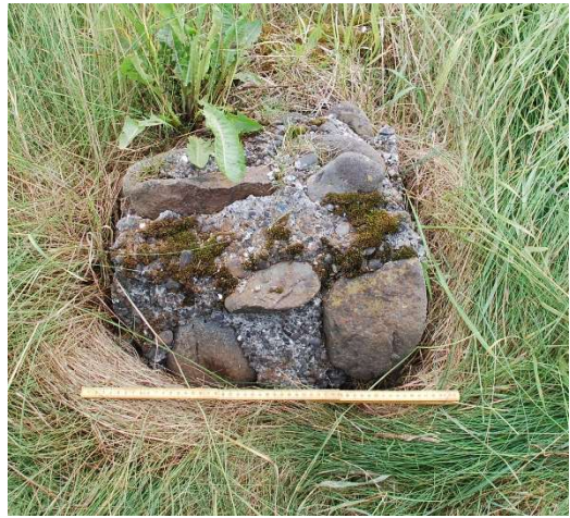
Mynd 5. Brot úr steypumannvirkinu. Tommustokkurinn er 60 sm.
