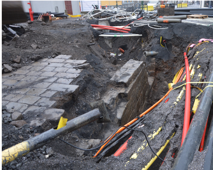
4 Gamlir lagnaskurðir sem þvera svæðið allt höfðu raskað minjunum. Horft til suðurs.
