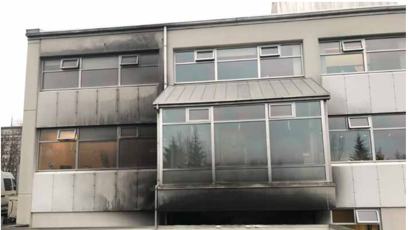
Betur fór en á horfðist þegar kveikt var í sorpgeymslu við Verkfræðingahús.
