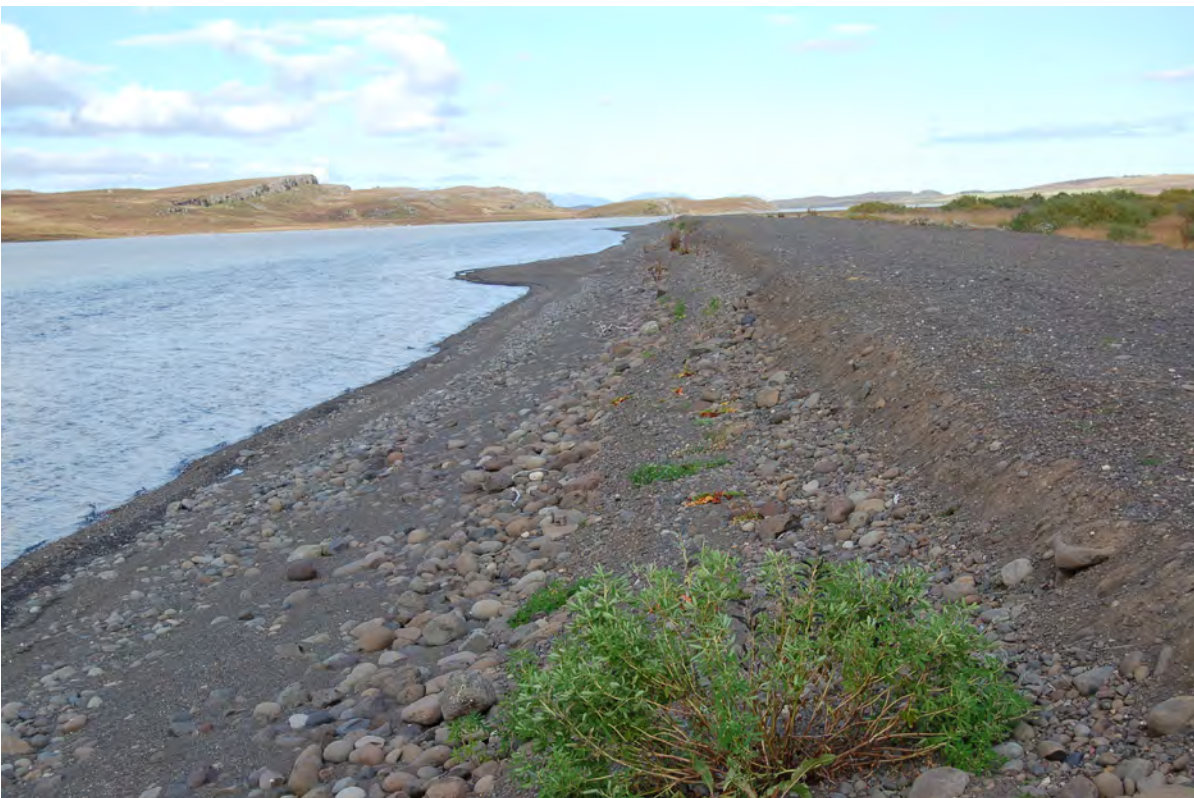
4. Ljósmynd. Vegur og bakkavörn á austurbakka Lagarfjóts við Finnsstaðanes, lagður árið 1988. Þarna hafid verið mikið landbrot en fyrir það tók er vegurinn var lagður. Ljós. Sigurður H. Magnússon, 20. sept. 2011.
