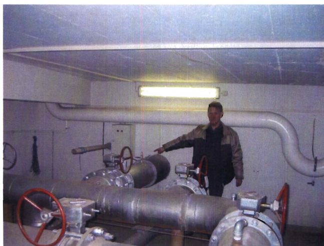
Mynd 10. Kjallari undir miðlunargeymi, Halldór bendir á inntak, sem er ekki virkt.
