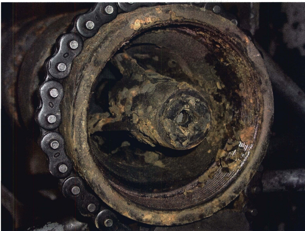
Mynd 9. Horft inn í neðsta þrep dælu. Leguhús öxuls fyrir miðju (botnlega). Lítilsháttar hrúður en engin útfelling eða óhreinindi.
