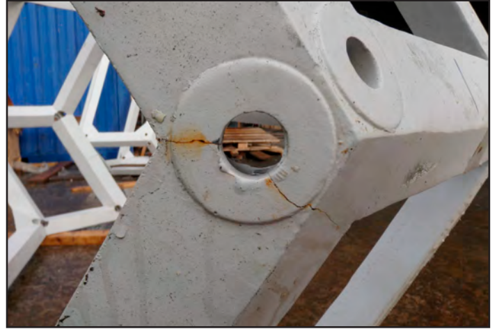
Mynd 10. Kubbar í geymslu og sprunga í horni eins þeirra.
