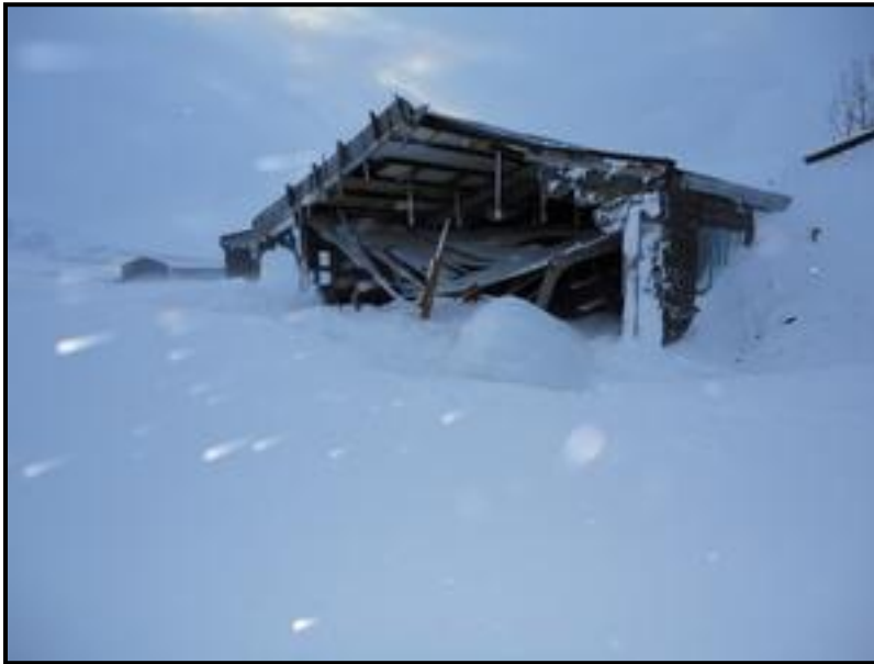
Mynd 8. Snjóflóðið lagði inn stafn á áföstu útihúsi.
