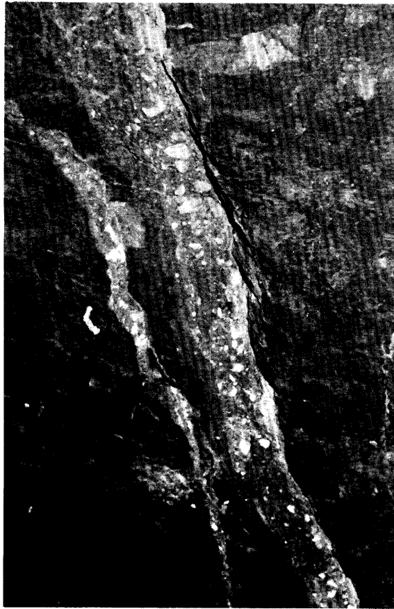
Ljósmynd 3. Írafossvirkjun. Setfylltar sprungur í lofti ganganna nálægt munna. Grannbergið er sandsteins-völuberg.
