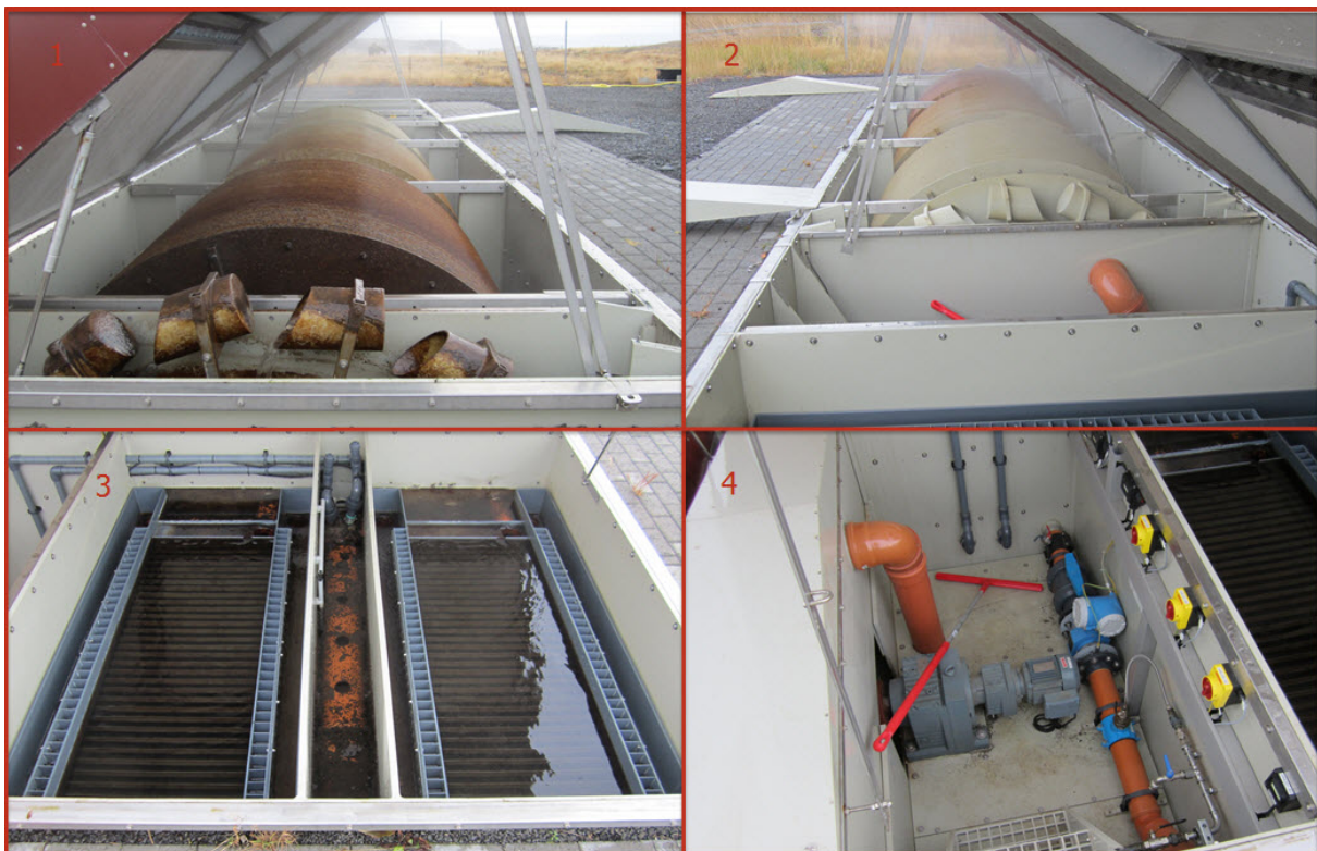
Mynd 5. Hreinsieiningin í Varmalandi. Fyrsta myndin sýnir skóflurnar sem dæla skólpinu yfir í diskaeiningarnar og fremstu diskana. Önnur myndin sýnir hinn enda diskaeininganna og skóflurnar sem dæla skólpinu yfir í plötuskiljuna. Þriðja myndin sýnir plötuskiljuna, þar sem örverurnar sökkva til botns og fjórða myndin sýnir stjórnþúnaðinn. (Myndir: Guðmundur Brynjúlfsson)
