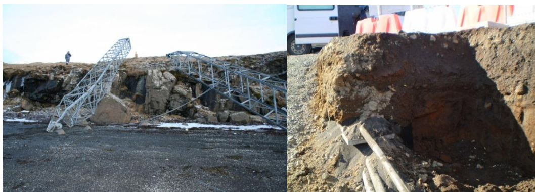
Mynd 10: Til vinstri bilun á 220 kV Brennimelslínu 1, viðgerðartími 30 klst. Til hægri bilun á 132 kV Nesjavallalínu 1, viðgerðartími 9 dagar.
