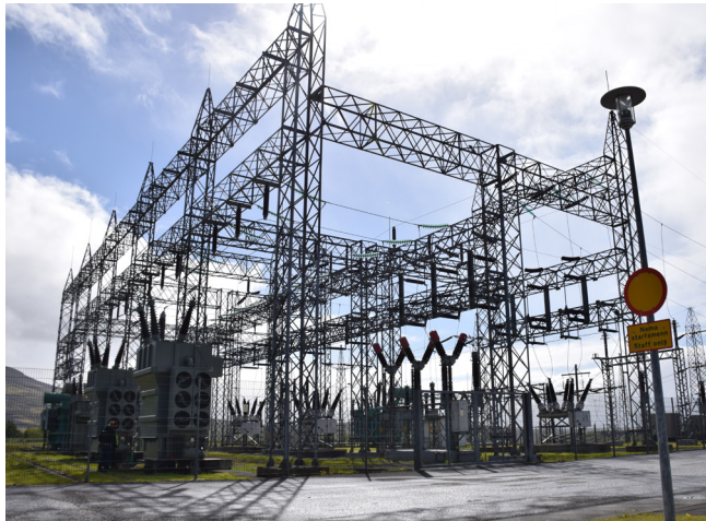
mynd 15: Tengivirki við Írafosstöð (GJ).
