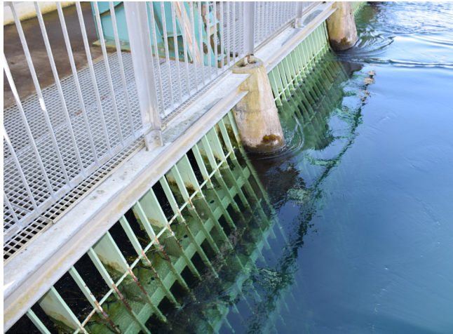
mynd 14: Inntak við Ljósafofsstöð (GJ).
