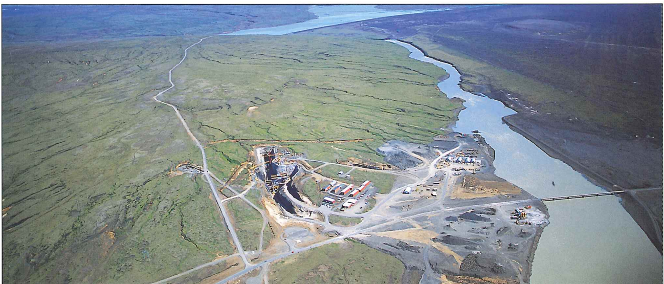
Horft yfir Sultartangavirkjun sem er í byggingu. Á miðri mynd sést stöðvarhússgrýfa þar sem aðrennslisgöng gegnum Sandafell opnast, og fremst fyrir miðju má sjá hluta frárennslisskurðar. Í baksýn er Sultartangastífla og -lón. Virkjunin verður 120 MW. Ljós. Oddur Sigurðsson.
