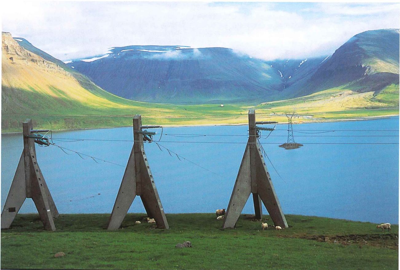
Vesturlína þar sem hún þverar Gilsfjörð. Horft er suður yfir fjörðinn til Ólafsdals. Línan tengir Vestfirði við orkukerfi Landsvirkjunar. Hún var tengd 1980 og er rekin á 132 kV spennu. Miðað við núverandi spennuvirki við Mjólkárverkjun getur Vesturlína flutt um 30 MW til Vestfjarða. Ljós. Oddur Sigurðsson.
