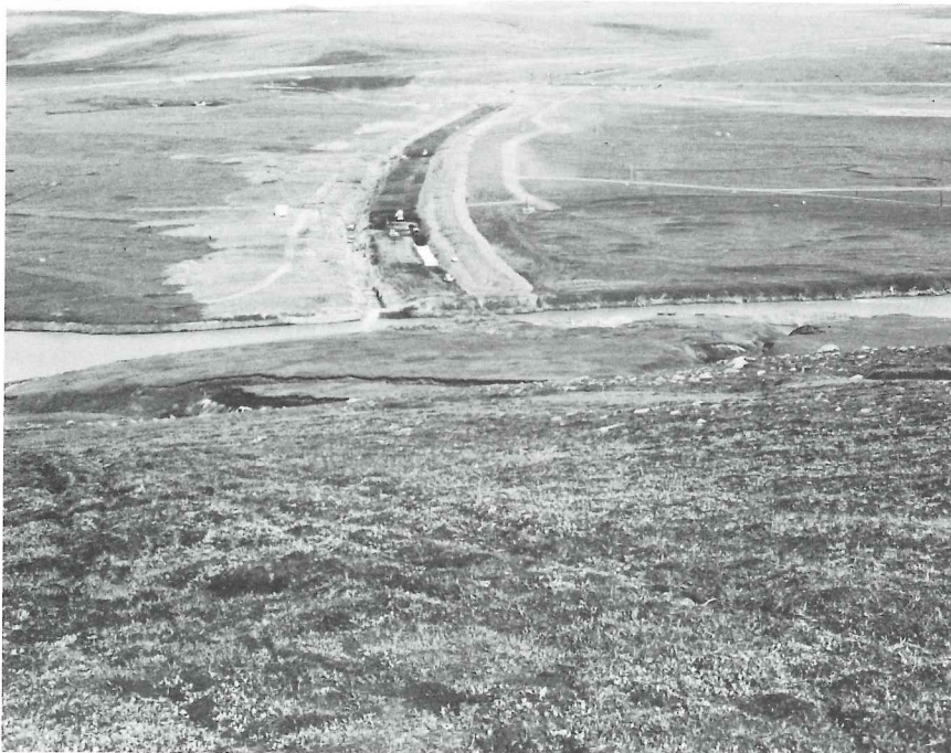
Sultartangi. Mynd tekin úr Sandfelli til austurs yfir Sultartangastíflu í ágúst 1982. Kjarnaskurður og stífla í byggingu en lengd hennar er um 6000 m. Í forgrunni er Þjórsá og sér í vinnubúðir lengst til hægri. Ljósmynd: Björn Jónasson.
