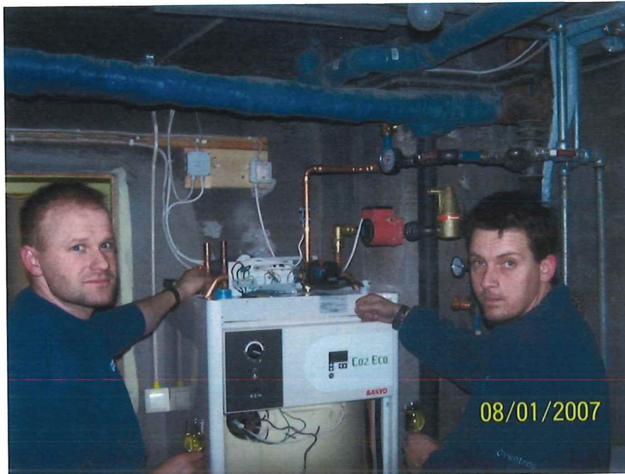
Mynd 4 Við lok uppsetningar koltvísýringsvarmadælu á Grýtubakka. Rafhitari ásamt stjórnborði sést, auk tenginga við raf- og vatnslagnir. Á myndinni eru Hallur Sighvatsson og Helgi Guðbergsson. Ljósmynd: Jónas Baldursson.
