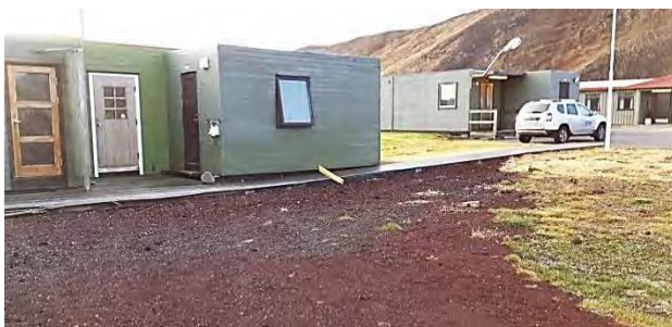
Mynd 4 Svefnálmur - 04.11.2016 ÁT Byggingar frá mismunandi tímum í mis góðu ásigkomulagi. Hurðir af ólíkri gerð og lit bæta ekki heildarásýnd.
