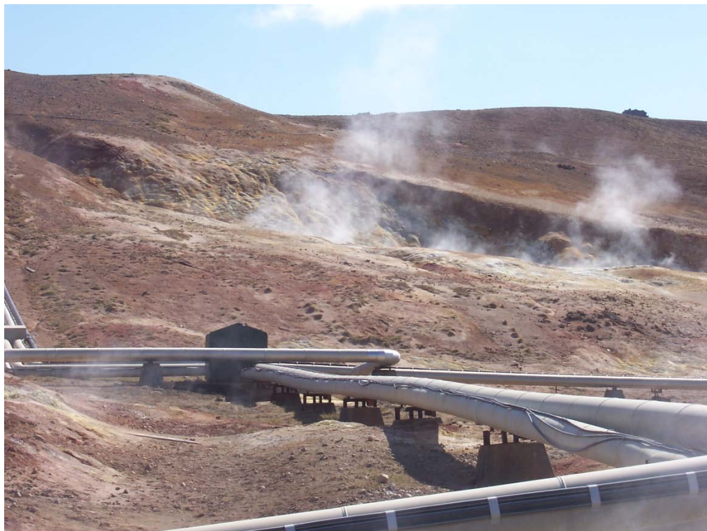
MYND 14. Séð af brúnni yfir gufulögnina á Gufustöðvarveginum yfir að BG-4.
