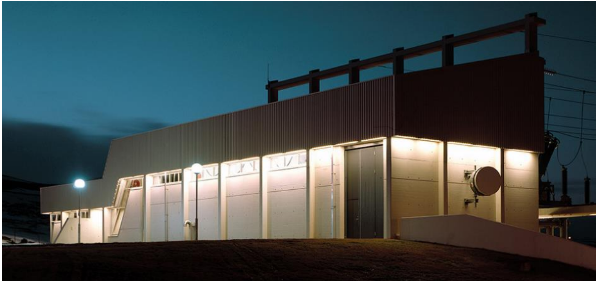
Mynd 7 Stjórnhús og tengivirki Blönduvirkjunar (Ljósmynd: LV)
