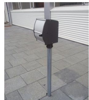
Mynd 5: Rafmagnsstaur (2x16A)
