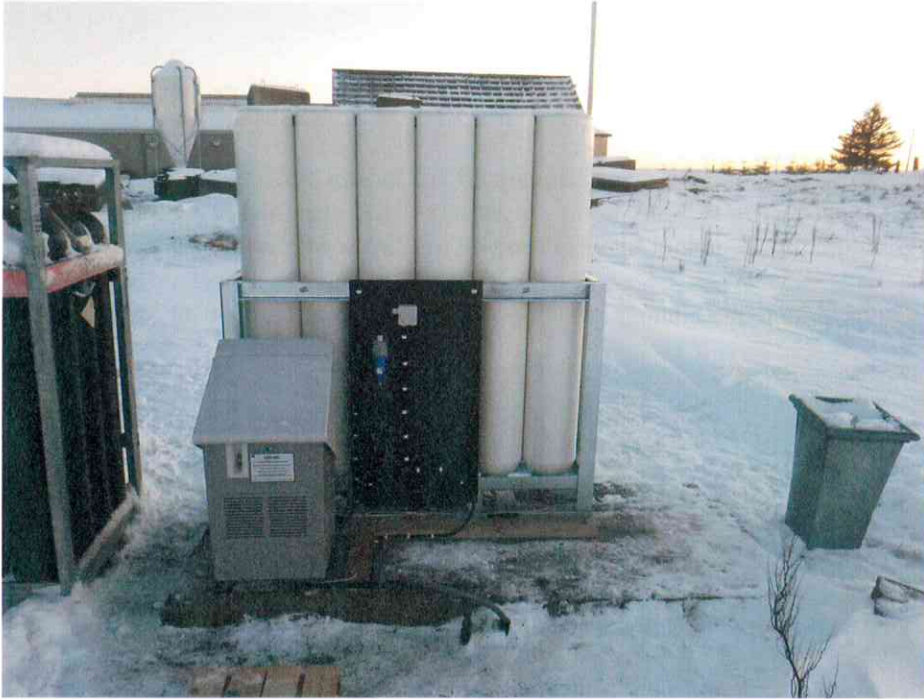
Mynd 13: Bakhlíð áfyllingarstöðvar. Ný áfyllingarpessa er tengd við háþrýstihylkin. Hylkin geyma 100 Nm 3 af metangasi við 207 bar.
