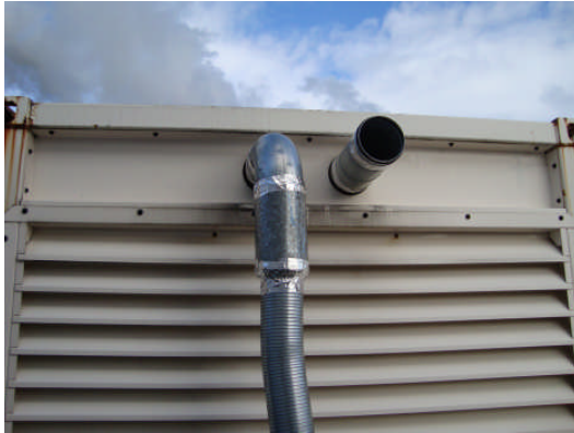
Afgasið fer í gegnum afgasröri inn í hreinsiturninn
