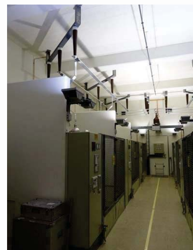
Rafbúnaður í nýrri viðbyggingu fyrir tengivirki.
