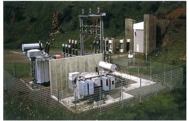
Spennivirki, inngangur að Laxárvirkjun 3 í baksýn.
