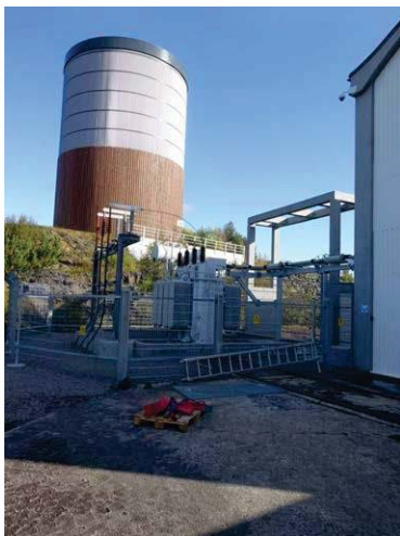
Þrýstivatnsturn frá stöðvarhúsi.
