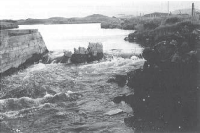
Miðkvíslarstífla eftir sprenginguna.
