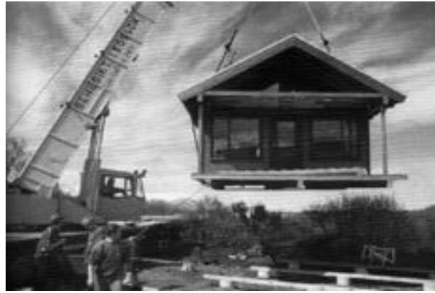
Unnið við að koma húsinu Kjarrlundu fyrir á undirstöðum í Aðaldal árið 1996. Þá átti OBHM sex orlofshús í Núpalandi.
