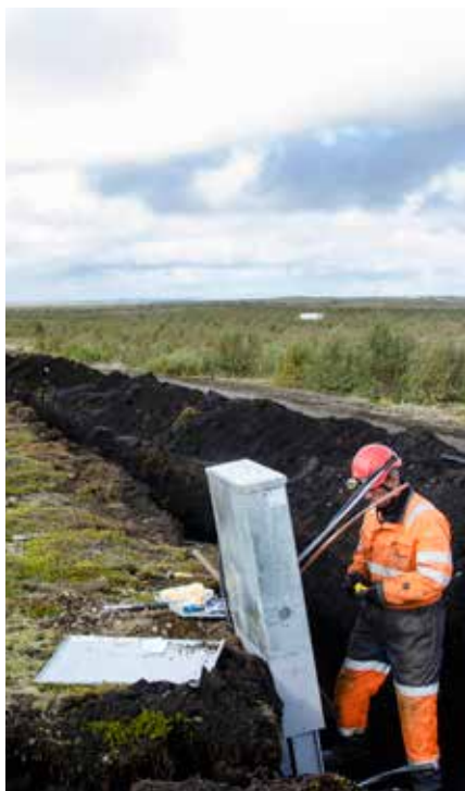
Þriggja fasa jarðstrengir eru nú um 53% af háspennukerfi RARIK og er samantölgð lengd þeirra um 8.700 km.
