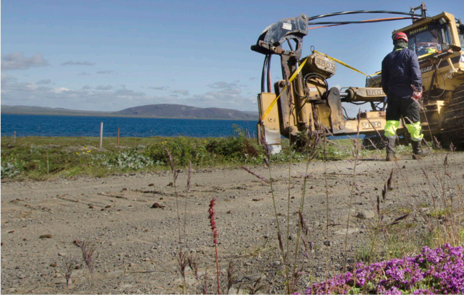
Jarðstrengslögn í landi Heiðarbæjar. Um 14 km jarðstrengur var lagður frá Nesjum í Grafningi að Skálabrekku í Þingvallasveit.
