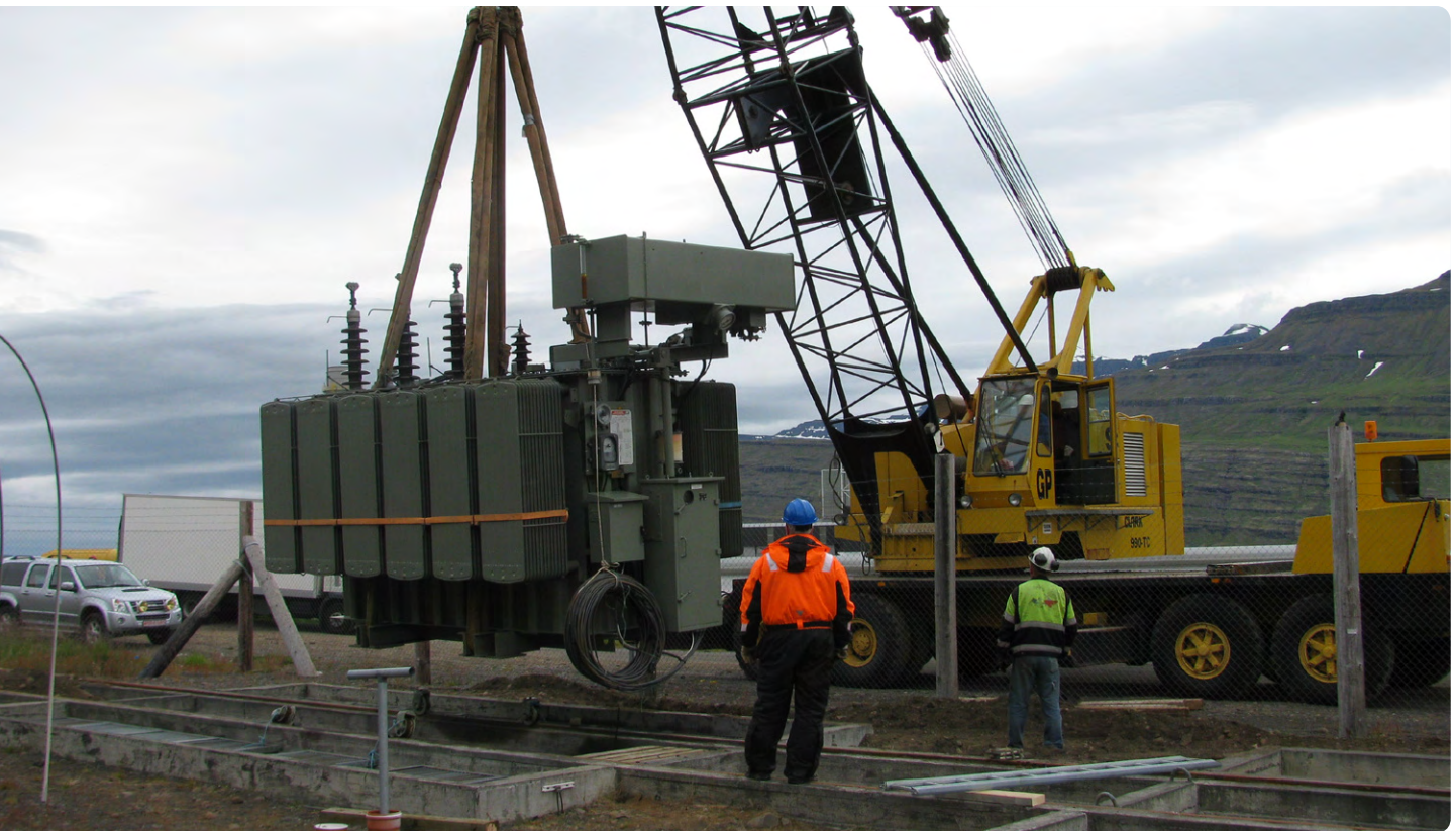
Aðveitustöð RARIK að Sómastöðum í Reyðarfirði var lögð niður á árinu, en hún hafði þjónað við uppbyggingu álvers Alcoa í Reyðarfirði, ásamt því að veita orku til Mjóeyrarhafnar. Aðveitustöð RARIK að Stuðlum í Reyðarfirði miðlar nú orku að Mjóeyrarhöfn.
