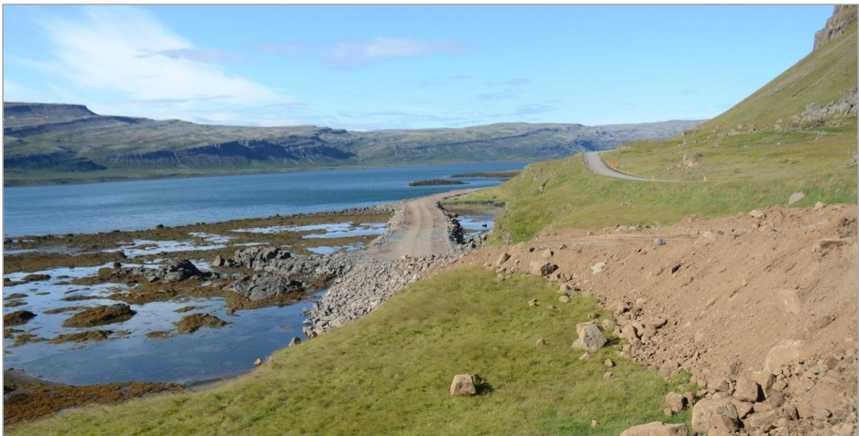
Mynd 4.1.2. Framkvæmdir við Vestfjarðaveg á Litlanesi í Kjálkafirði (ljósmynd: G. Pétur Matthíasson, 2013).
