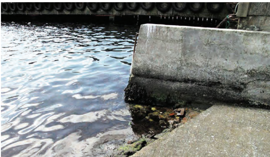
Figur 48. Nedre kant av beddingen på slipp F3, der det planlegges en tverrstilt stopper i underkant.
